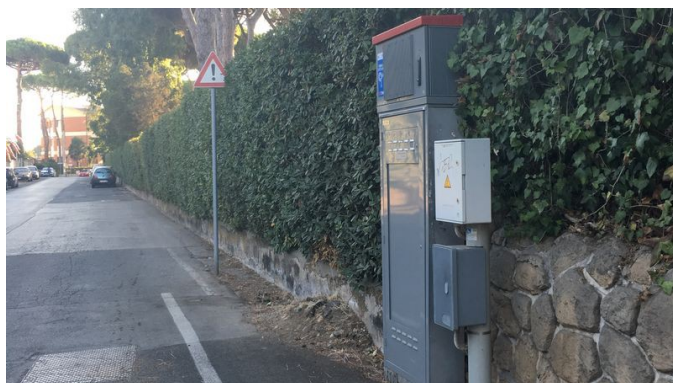
Fig. 1: una tipica installazione di DSLAM fibra in strada, riconoscibile dal tettuccio rosso e dalla palina con il contatore luce per l'alimentazione.
