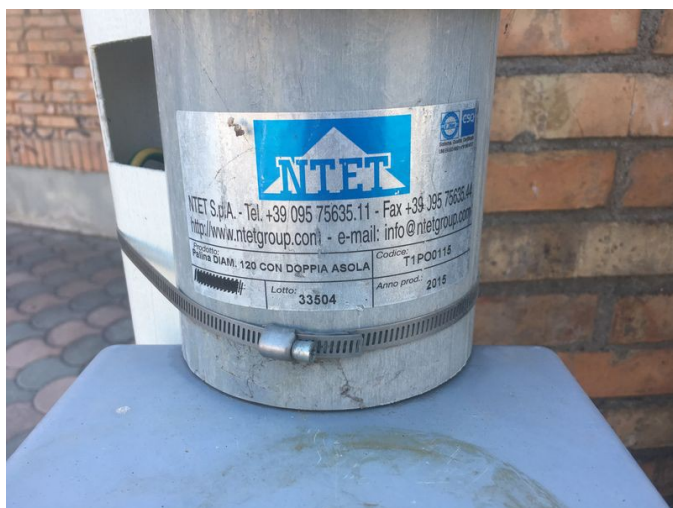
Fig. 2: uno dei produttori appaltati per la costruzione dell'«upgrade» alla fibra degli armadi.
